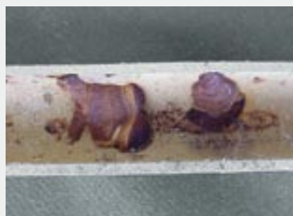
Undgå korrosionsskader i brugsvandsanlæg
